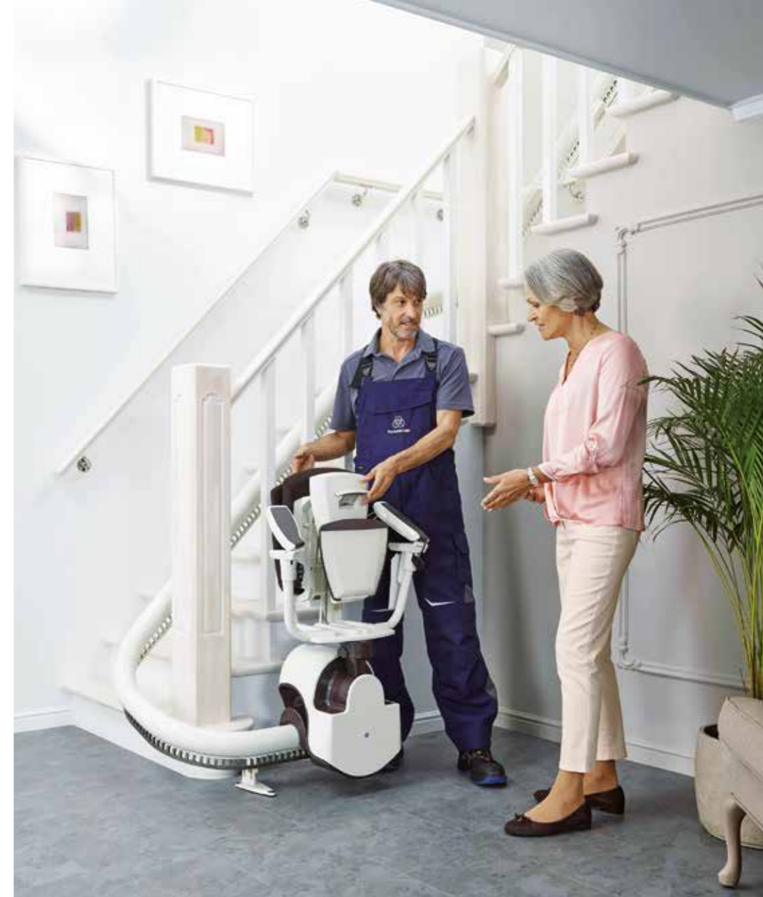
Der Staat bezuschusst die Treppenlift-Installation unter bestimmten Voraussetzungen. Foto: thyssenkrupp Encasa/akz-o
