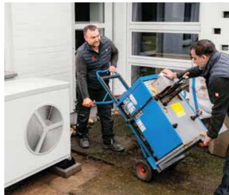
Experten aus dem Heizungshandwerk beraten zu den Möglichkeiten und übernehmen die fachgerechte Modernisierung. Foto: DJD/Stiebel Eltron
