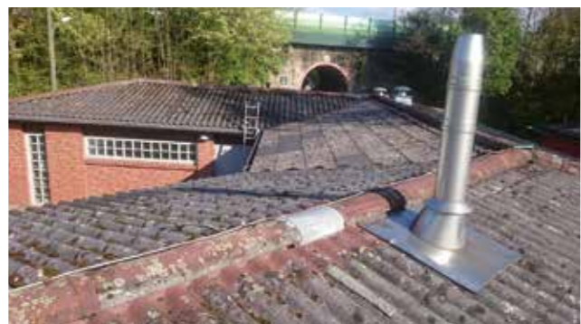
Der Kabinen- und Wohntrakt des Fußballvereins VFR Sölde vor der Sanierung mit einem Wellplattendach aus Asbestfasern.
